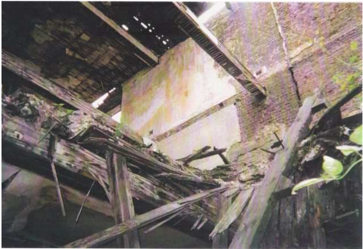
Vue de l'étage à travers le plafond effondré
